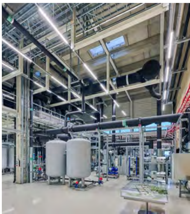
Die Energie- und Medienversorgung ist eines der anspruchsvollsten Themen in der technischen Gebäudeausrüstung.
