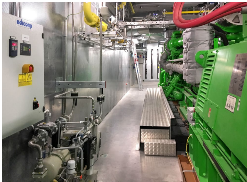
Innenansicht des Aufstellraums für das BHKW-Modul I
