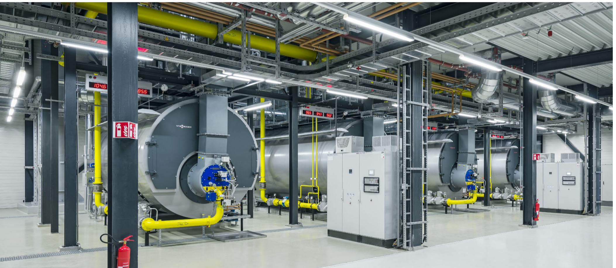
Ebene 1: Vier Heisswasserkessel, je 12.000 kW, mit Zweistoff-Brenner
